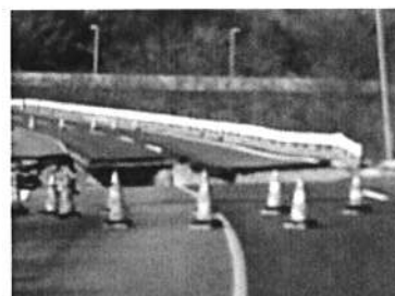
寸断された道路
